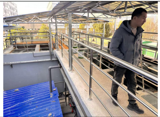
污水站主要处理单元现状
